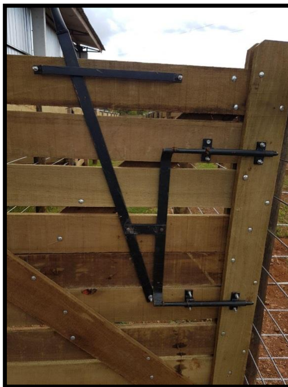
FOTO 08 - Detalhe das trancas que serão colocadas nos portões do sistema de manejo.
